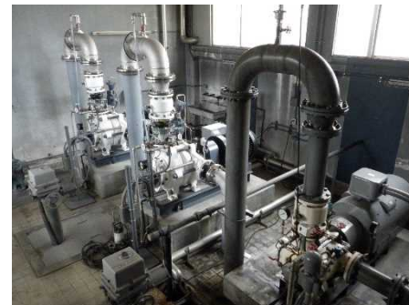
写真2.9 佐古浄水場配水ポンプ
