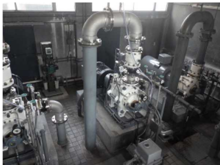
写真2.4 佐古浄水場配水ポンプ
