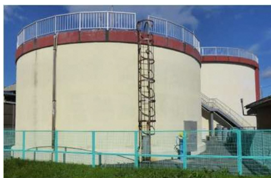
写真 2.3 場外施設配水池
