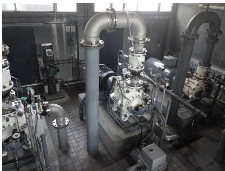
写真 2.4 佐古浄水場配水ポンプ
