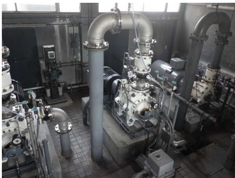
写真 2.4 佐古浄水場配水ポンプ
